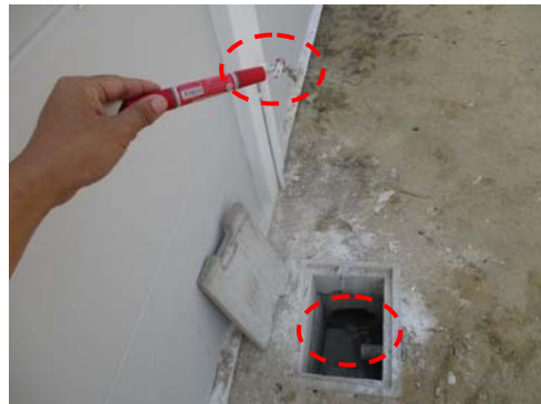
Pic:2 ข้างบ้าน ก๊อกละอะสี ควรทำความสะอาดใหม่ และ ลอกทำความสะอาดภายในบ่อพักให้สะอาด
