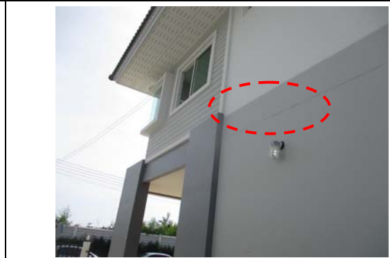
Pic:12 ข้างบ้าน ชิ่งน้ำกระเบื้องห้องน้ำแล้ว มีน้ำซึมออกภายนอกผนัง ควรตรวจสอบแก้ไขทำกันซึมห้องน้ำใหม่
