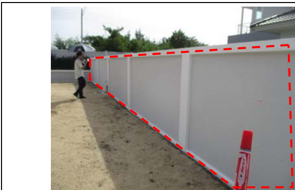
Pic:1 ข้างบ้าน รั้วปูนมีรอยร้าวทุกแผง และคราบสีทุกแผง ควรโป้วขัดเก็บสีใหม่ และ ทำความสะอาดใหม่ให้เรียบร้อย
