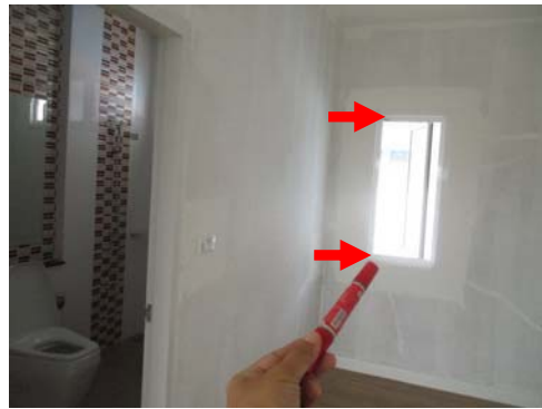
Pic:16 ห้องนอน1 บานหน้าต่างหลังบ้านมีน้ำซึม ควรตรวจสอบแก้ไขเก็บงานซีลิโคนภายนอกใหม่รอบชุด และ บานต่างอลูมิเนียมมีรอยบวบ ควรเปลี่ยนใหม่
