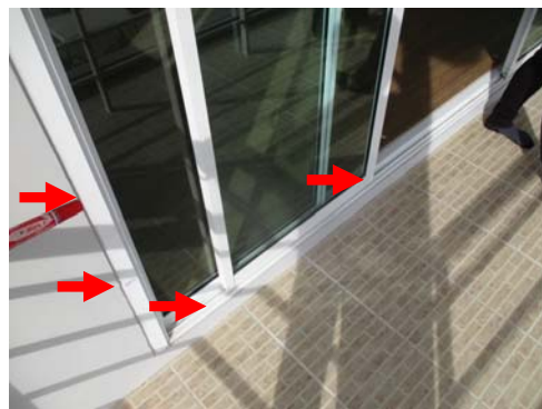
Pic:18 ห้องนอน1 ขอบปูนบานประตูไม่เรียบ ควรจัดเก็บสีใหม่ รอบชุด
