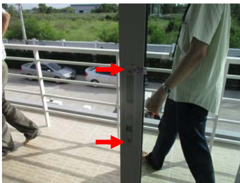
Pic:17 ห้องนอน1 มือจับบานประตู ฝาปิดหัวน็อตไม่มี ควรติดตั้งให้เรียบร้อย
