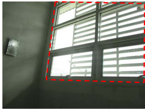
Pic:8 บานหน้าต่างอลูมิเนียมและคราบทั่วทั้งบาน ควรทำความสะอาดใหม่
