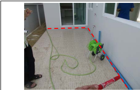
Pic:7 หลังบ้าน กรวดรอบลานซักล้างไม่เต็ม ควรโรยกรวดใหม่ให้เต็ม
