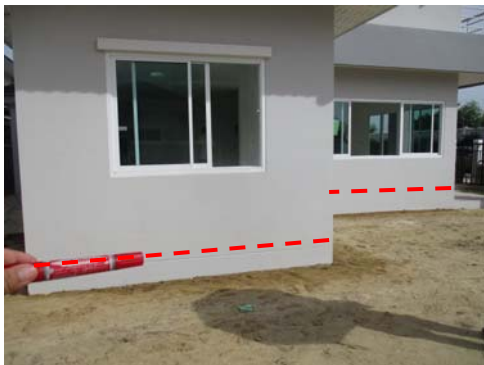
Pic:5 ข้างบ้าน เสาร่องผนังช่วงล่างไม้เรียบทั้งแนว ควรเซาะร่อง ใหม่ให้เรียบทั้งแนว
