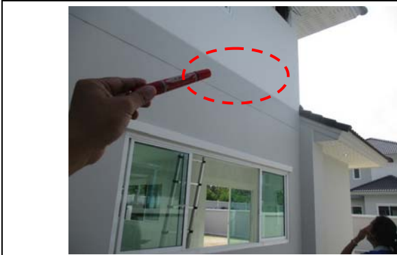
Pic:11 หลังบ้าน ชิ่งน้ำกระเบื้องห้องน้ำแล้ว มีน้ำซึมออกภายนอกผนัง ควรตรวจสอบแก้ไขทำกันซึมห้องน้ำใหม่
