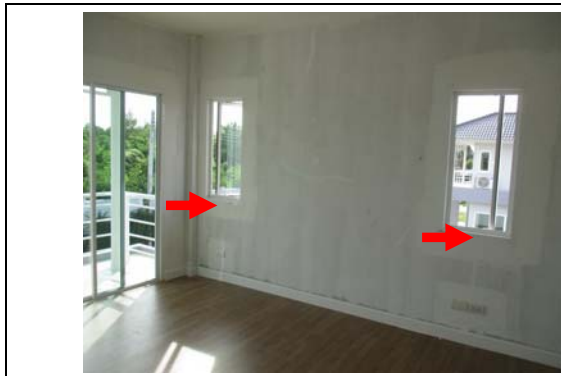
Pic:13 ห้องนอน1 บานหน้าต่างข้างบ้านมีน้ำซึม ควรตรวจสอบแก้ไขเก็บงานซีลิโคนภายนอกใหม่รอบชุด และ บานหน้าต่างอลูมิเนียมภายนอกตรงมุมบวบ งอ ควรเปลี่ยนใหม่
