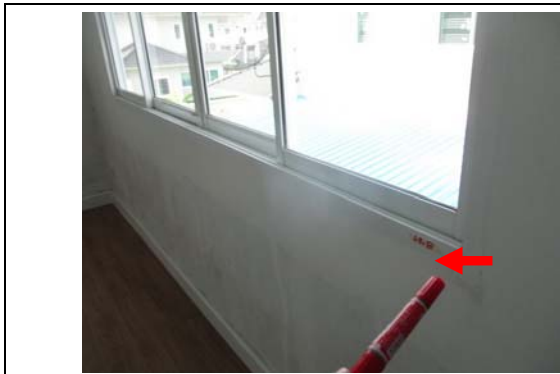
Pic:31 ห้องนอน3 บานหน้าต่างหลังบ้านมีน้ำซึม ควรตรวจสอบแก้ไขเก็บงานซิลิโคนภายนอกใหม่รอบชุด
